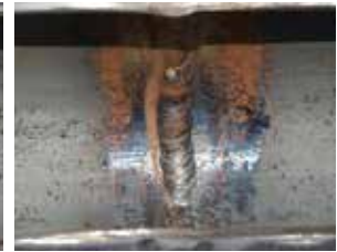
Rohr aus Stahl: Formiergas Stickstoff
