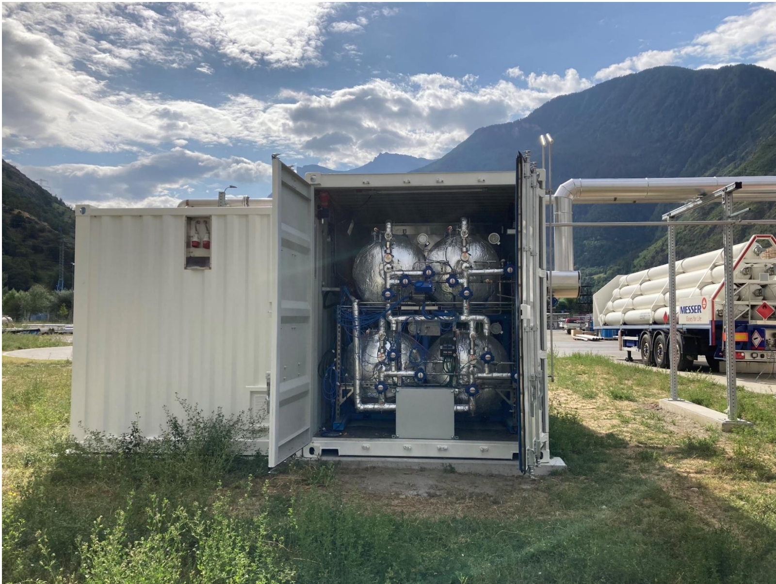
Thermischer Verdichter zur Befüllung von Wasserstofftrailer am Standort Visp, Wallis, Schweiz
